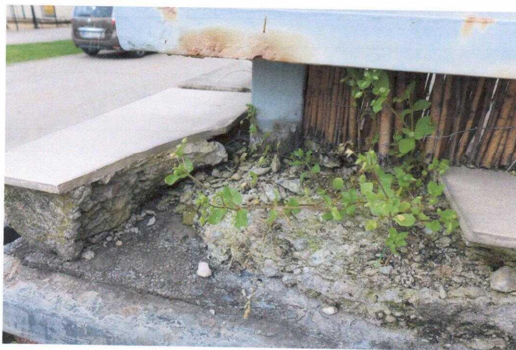
fot. 8. Widok zniszczeń narożnika tarasu- widoczny przekrój przez warstwy i korozja balustrady
