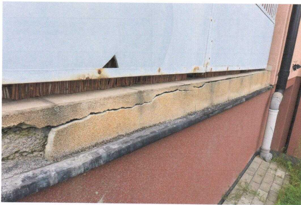
fot. 7. Widok zniszczonego tynku nad opierzeniem ścianki bocznej
