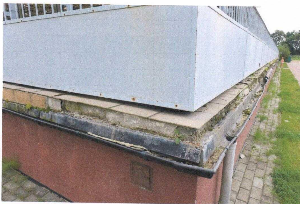
fot. 6. Widok zniszczonego narożnika tarasu
