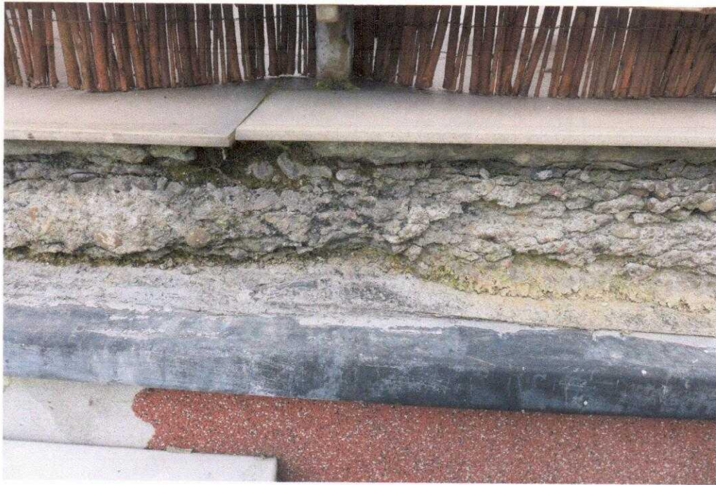
fot. 11. Widok destrukcji wylewki betonowej nad pasem nadrynnowym
