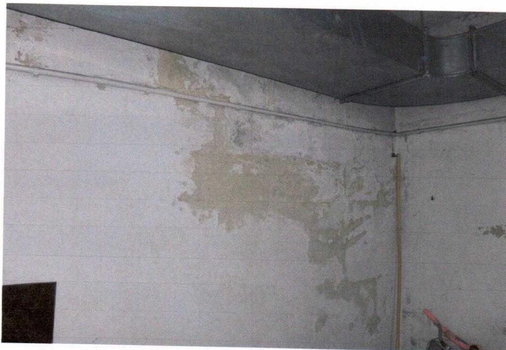
fot. 01. Destrukcja tynków i powłok malarskich w hali garażowej w miejscach występujących przecieków
