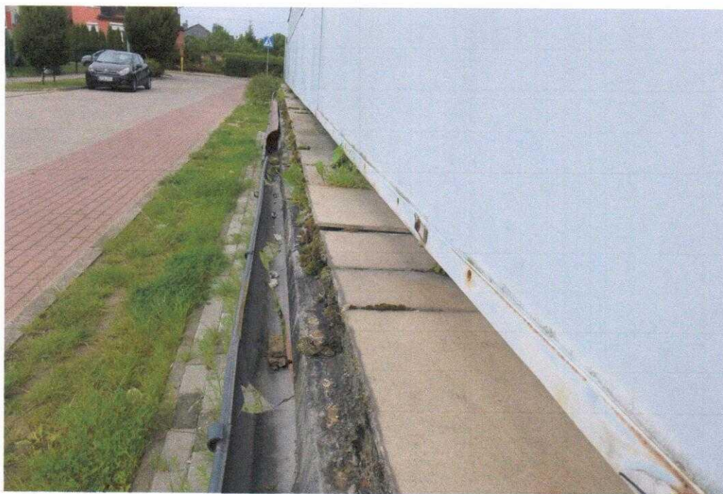
fot. 3. Widok ogólny zniszczonego pasa nadrynnowego i okapu
