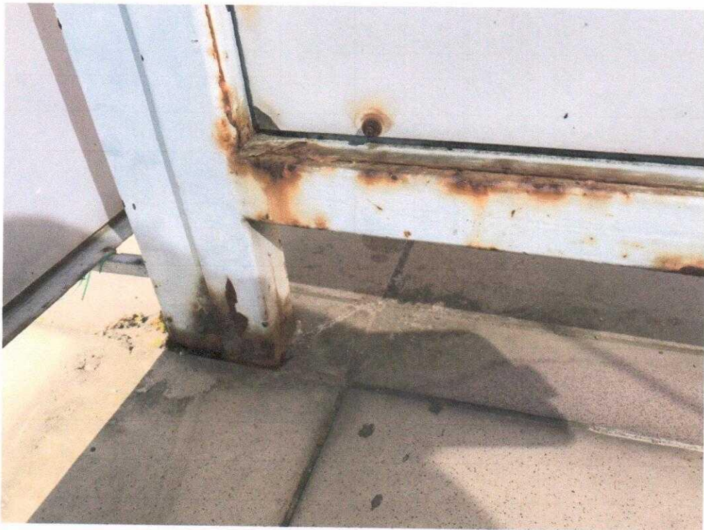
10. Korazja elementów stalowych barierek tarasu, widoczne uszkodzenia płytek
